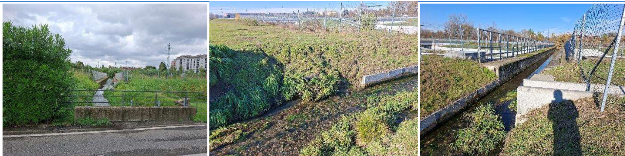
Foto 14: vista da 18 verso monte; si vede in sx idrografico il tubo di scarico ECOPAL 630 + il canale prefabbricato in cls e in dx il tubo in PEAD, tutti probabili scarichi di acque di abbassamento falda e pioggia della Nuova Cassanese – il 29/8/2025 si misurava una altezza idrica di 0,4 m a monte dello scarico (larghezza canale 2,4 m) e una velocità in sommità al centro di 0,5 m/s – se ne deriva una portata indicativa di 2,4 \times 0,4 \times 0,5 \times 0,6 = 0,28 \text{ m}^3/\text{s}
