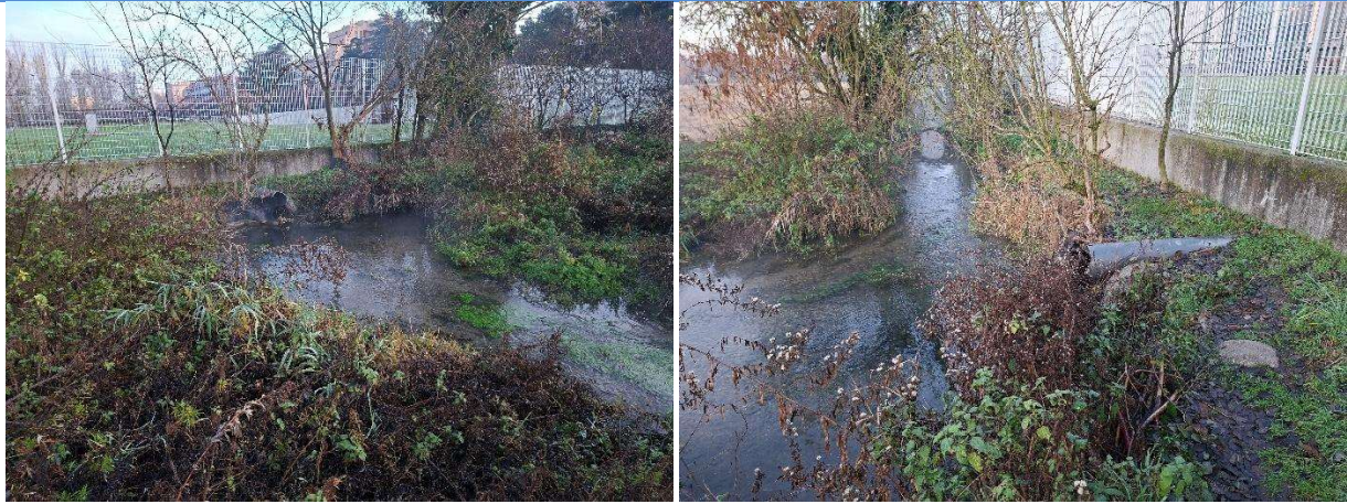
Foto 4: afflusso in sx in 39 (PVC grigio 315); a dx si vede tubo diametro 80 cm lunghezza 1,0 m attraversamento
