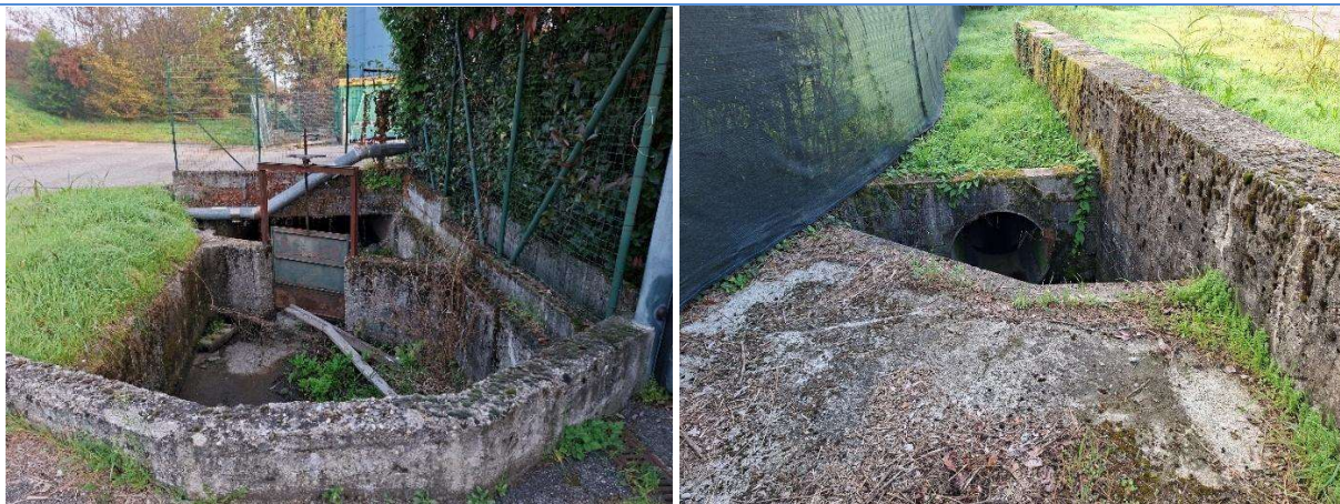
Foto 58: diramazione a valle attraversamento accesso alla centrale termica San Felice; a destra tratto verso Longhignana
