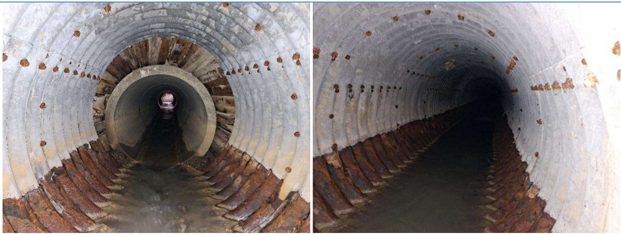
Foto 55: a sx vista verso monte dalla cameretta punto 5; a dx vista verso valle dalla cameretta medesima dell'attraversamento ferrovia
