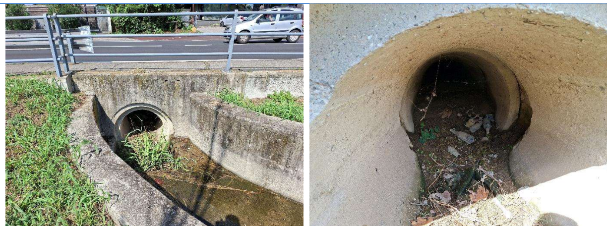
Foto 28: sbocco sezione 2 attraversamento via Martiri di Cefalonia con particolare dell'attraversamento tubazione cls 100 cm
