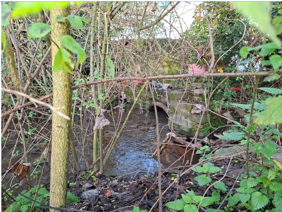
Foto 11: sbocco tombinatura Centro Islamico; si osservano 2 tubi cls 700 intasati di materiale terroso per oltre la metà
