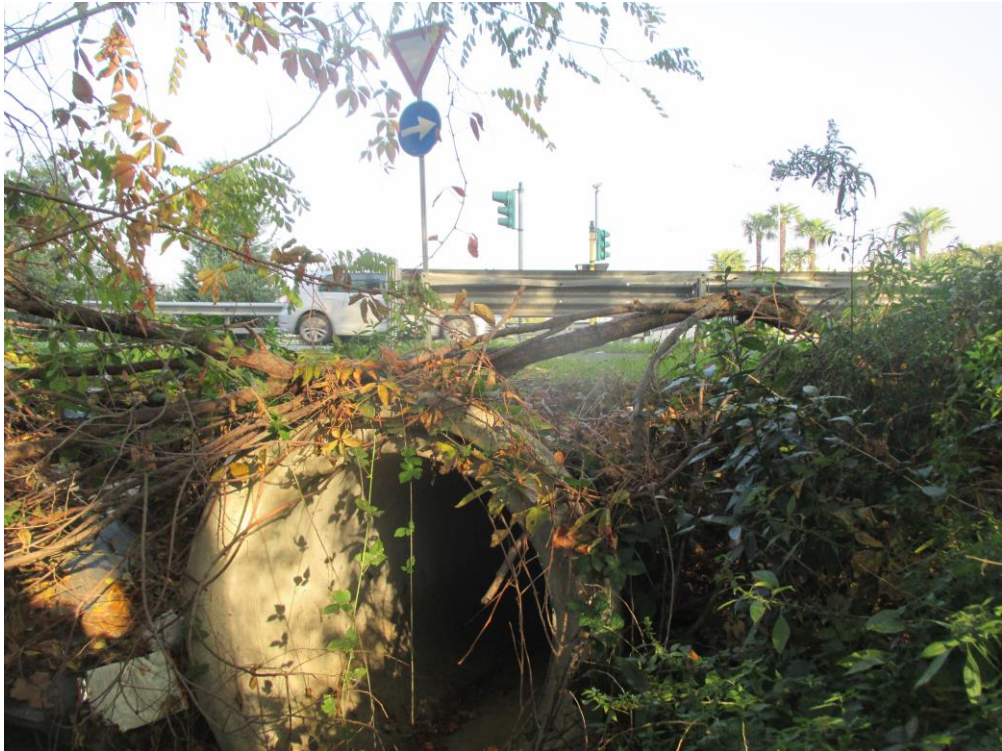
Foto 3: Tubazione in cm con diametro 100 cm uscente da sottopasso di Via Cassanese
