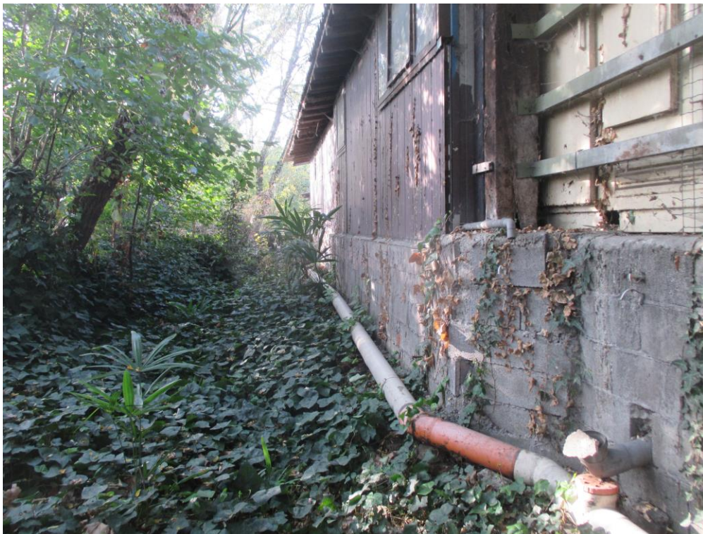
Foto 5: corso d'acqua con sponda destra costituita da muro di manufatto.
